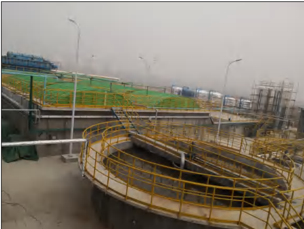
图 4-1 污水处理站现状
